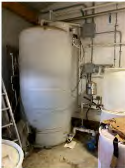
Figure 17. Réservoir de stockage de l'eau récupérée à la Ferme Edriphaniel (eau pluviale et eau de lavage du système de traite) (source : Agrinova)
