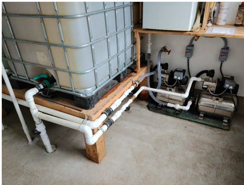
Figure 5. Réservoir d'eau récupérée et pompes d'un système de récupération d'eau de lavage
