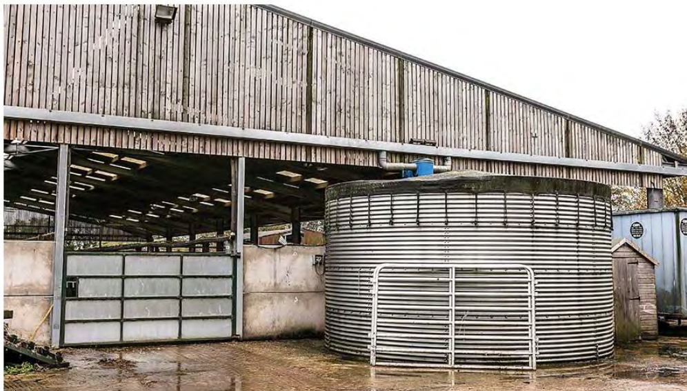
Figure 7. Système de récupération d'eau de pluie sur la toiture d'une ferme avec gouttière (source : FW)
