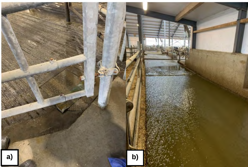
Figure 21. Trappes d'arrivée d'eau (a); et drain d'évacuation du système de chasse d'eau (b) à la Ferme Irma (source : Agrinova)
